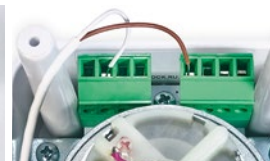
Фото 15. Подключение датчика к электроприводу
